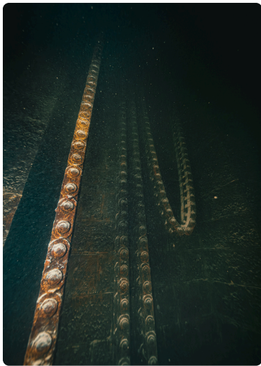
Chânes Galle à plaques du mécanisme de levage des vannes. © André PiedPalmé.
